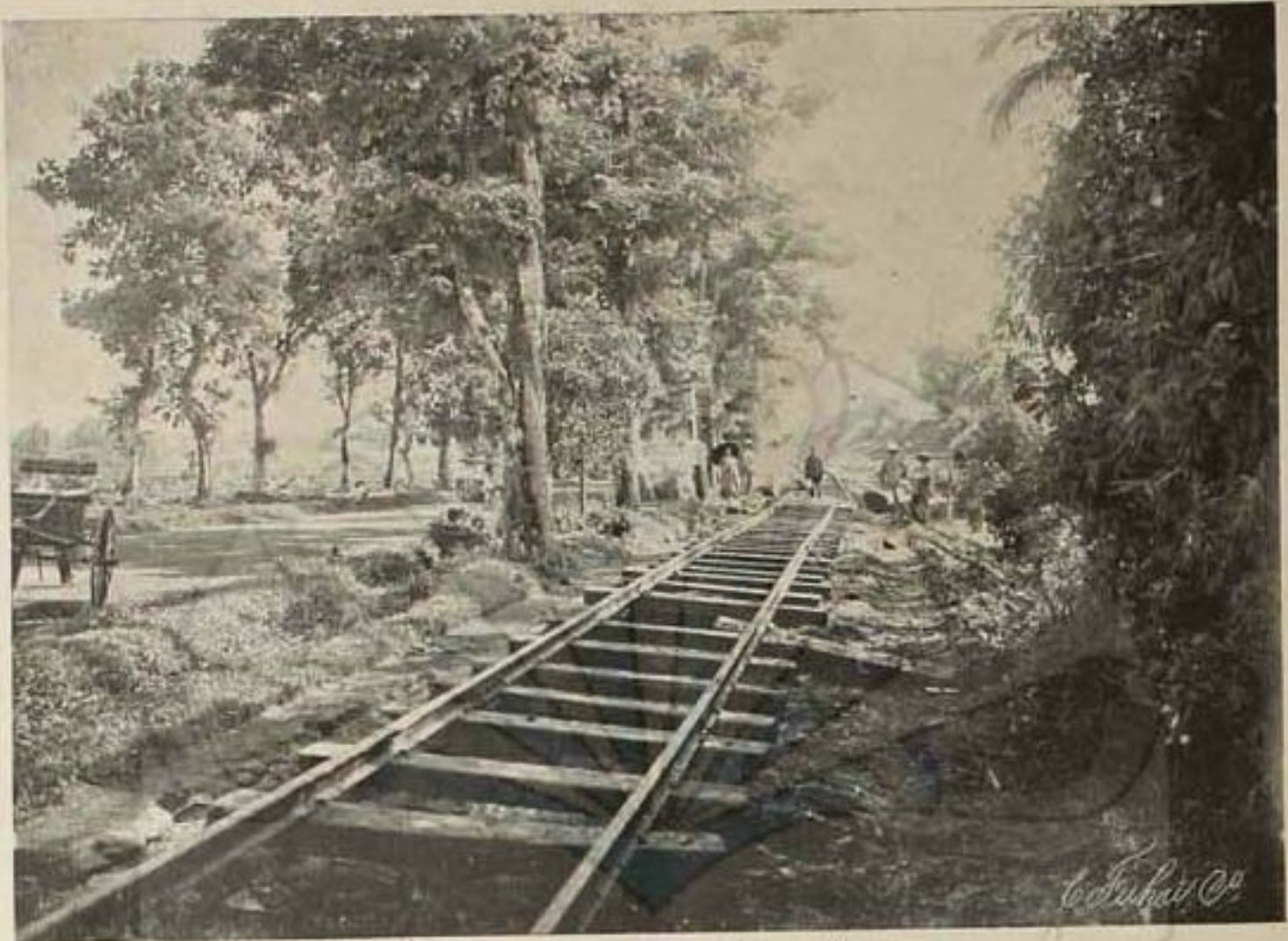
VERBOGEN RAILS VAN DE BAAN DER MALANG-STOOMTRAM.
